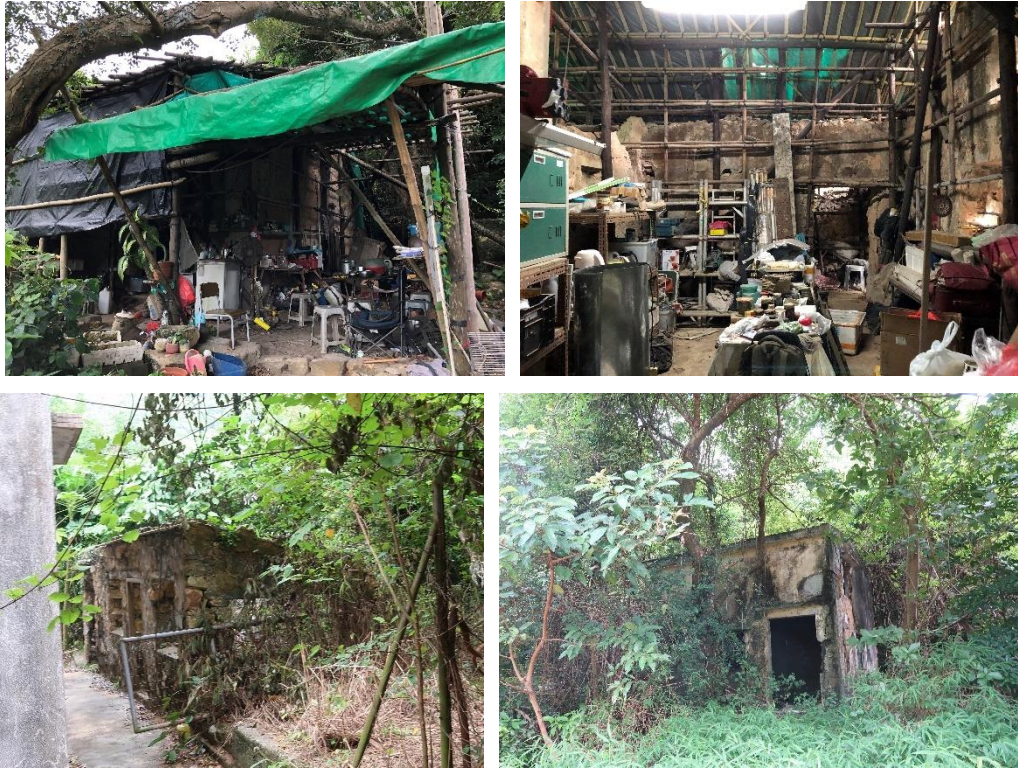
圖 212. 二澳新村舊屋的狀況，2020年。
